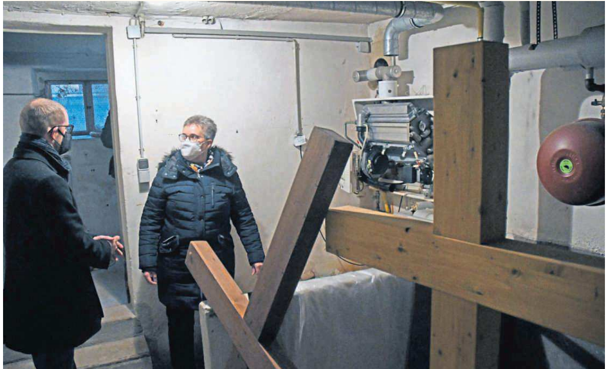
Der Heizkessel im Keller der evangelischen Christuskirche in Windischeschenbach ist kaputt. Jetzt bemüht sich die Gemeinde, das Geld für einen Austausch zusammenzubekommen.
